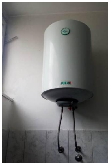
Slika 1.8. Akumulacioni bojler instalisan u objektu
