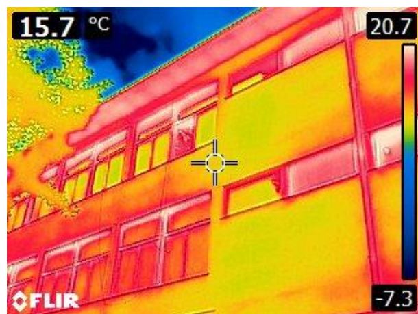
Slika 3. Termovizijski snimak sjeverozapadne fasade objekta.
